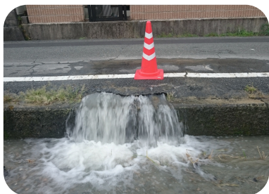
▲配水管からの漏水
