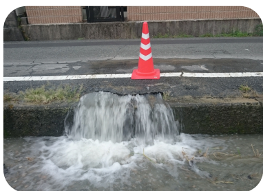
▲配水管からの漏水
