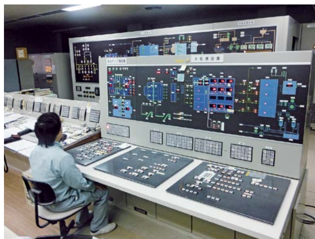
▲ポンプ場内を監視するシステム
