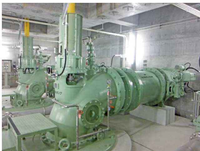
▲場内に設置したポンプ
