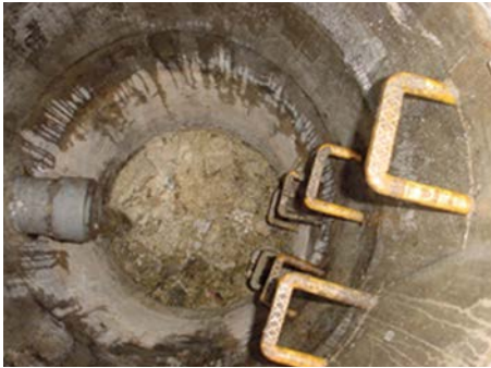
油脂が流れてきて固まり下水道管が詰まっている状態
